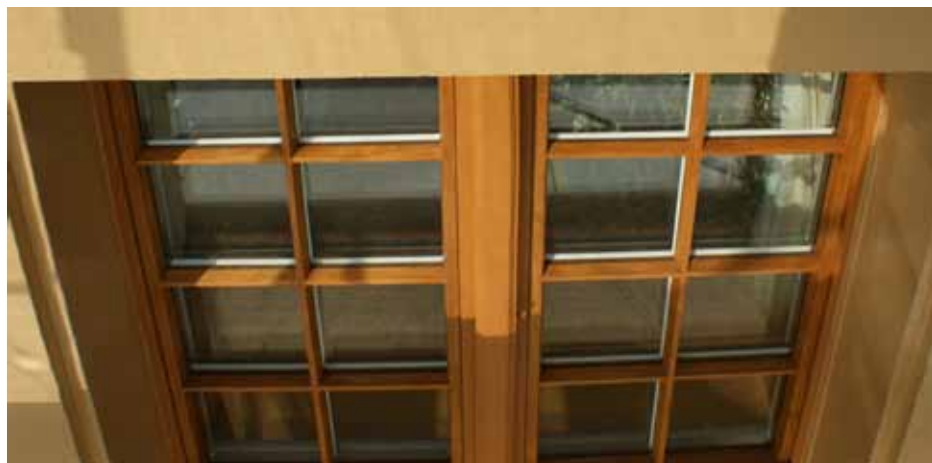
Die Fensterrahmen sind nicht mehr weiss. In diskretem Eichenbraun fügen sie sich harmonisch in das neue Farbbild der Fassade ein (östliches Giebelfenster im 3. Stock).
